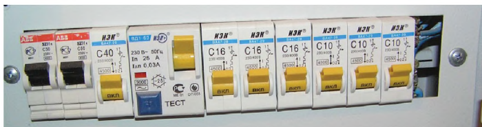
Рис. 10. Автоматические выключатели, установленные в электрошкафу (щитке)
