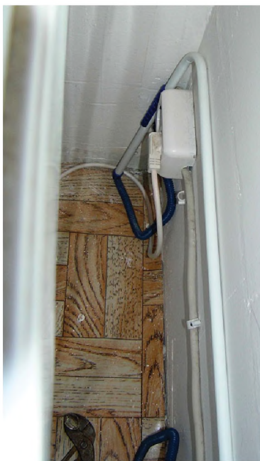
Рис. 75. Розетка для открытой проводки с подключенной к ней стиральной машиной
