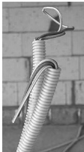
Рис. 12. Проводка в ПВХ-трубах
