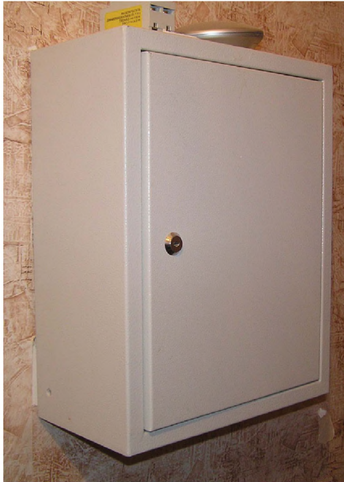
Рис. 7. Электрощиток в квартире
